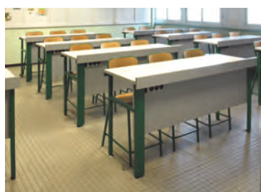
Goulotte Contre-pieds Métallique destinée au câblage des prises de courant sur les tables sèches. Attentes au droit du pieds... (B)
