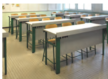
Goulotte Contre-pieds Métallique destinée au câblage des prises de courant sur les tables sèches. Attentes au droit du pieds... (B)
